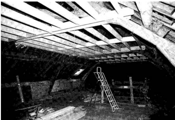
Plafonnement au niveau des entrails de la charpente laissant un comble perdu accessible par la toiture à isoler phoniquement
